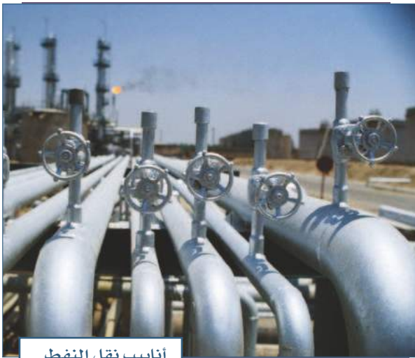
أنابيب نقل النفط
